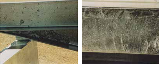
Şekil 9. Curüftan kaynaklanan enklüzyonların yüzeyde belirginleşmesine örnekler
