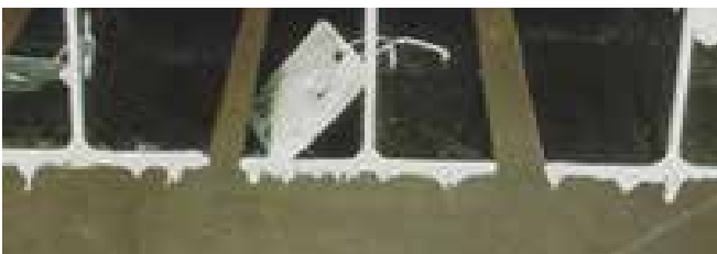
Şekil 8. Drenaj çıkıntıları isimli hatalara ait yüzey görüntüsü
